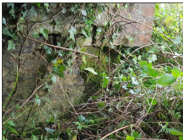
Figure 6 : Ligne 325 000 : Double fracture sur la culée C0
