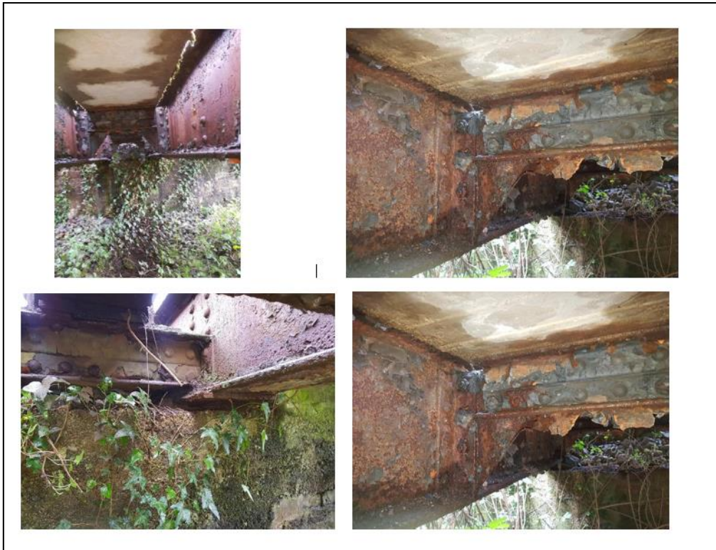
Figure 5 : Ligne 325 000 - Avaries du tablier métallique à poutres jumelles
